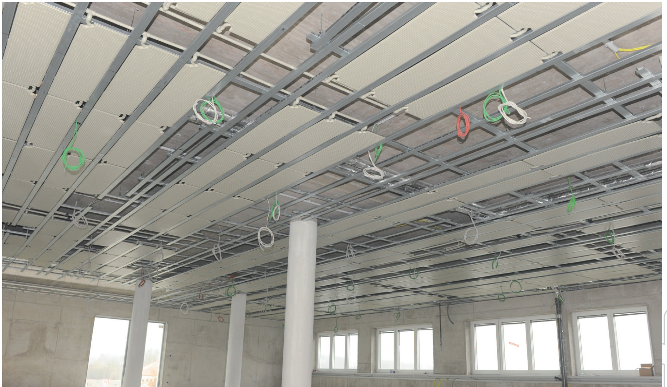
Sofisticirane tehnike montaže omogućuju različite primjene modula klima-strop.
